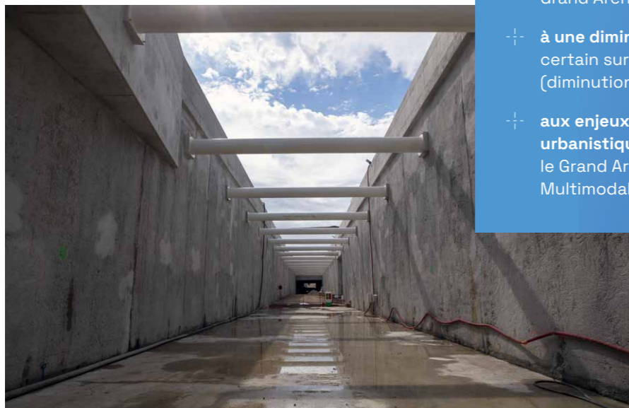
Secteur B - Entrée/Début de l'ouvrage située au droit de l'ancienne gare Saint-Augustin - réalisation des radiers (de la rampe d'accès à l'ouvrage)
