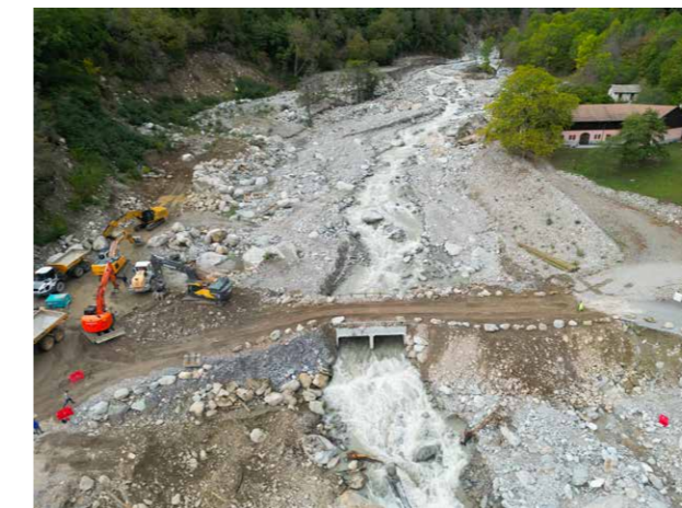
Saint-Martin-Vésubie - RM 2565 entre les ponts de Venanson et Maïssa : chantier en cours
